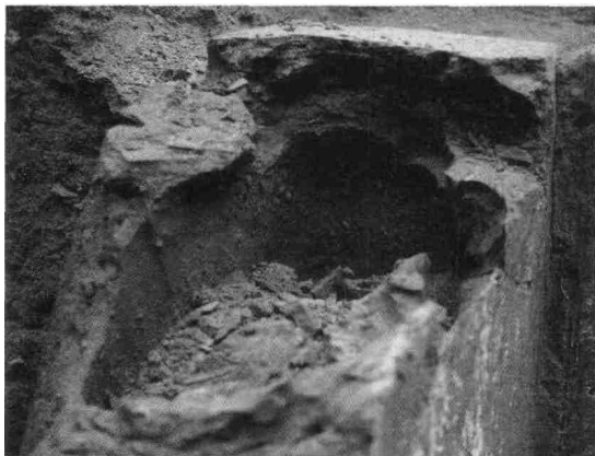
图五 郑州市秦岭路东汉空心砖墓空心砖内壁泥痕 块中泥的纹路呈分散状，并不是纹理一致的块状。（图四、图五）这种现象说明，空心砖两端的不是由一个整泥片粘接而成的，而是用泥由内而外涂抹而成的。
